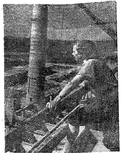
Meie üliõpilasbrigaadi staabi ülem, energeetikateaduskonna üliõpilane Evi Näppo heidab pilgu ehitustandri elektrijaama peakorpuse katusele.
