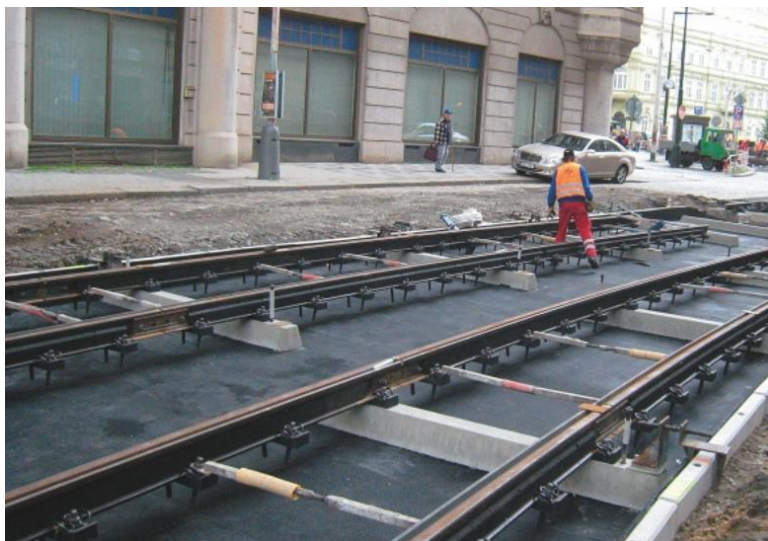
Joonis 4.14 Trammitee pealisehitise alune vibratsioonimatt Prahas [37]
