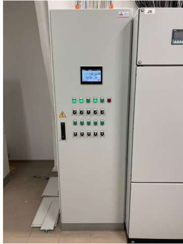
Joonis 2.13 Jahutussüsteemi ja kliimaseadmete juhtimise eest vastutav pult
