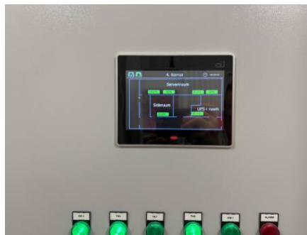
Joonis 2.14 Ekraan puldil, mis vastutab jahutussüsteemi ja kliimaseadmete juhtimise eest
