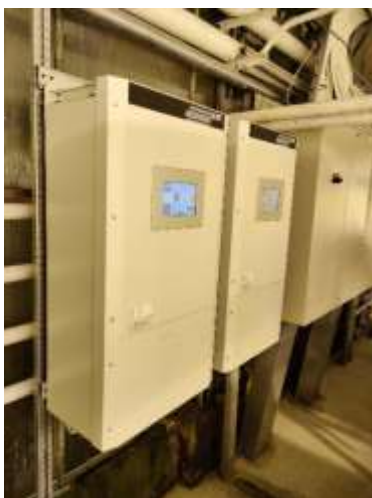
Joonis 3.17. Näidispaigaldus aktiivfiltritele ettevõttes, filtrite koguvõimsus 200 kVA, nimipingega 400 V.
