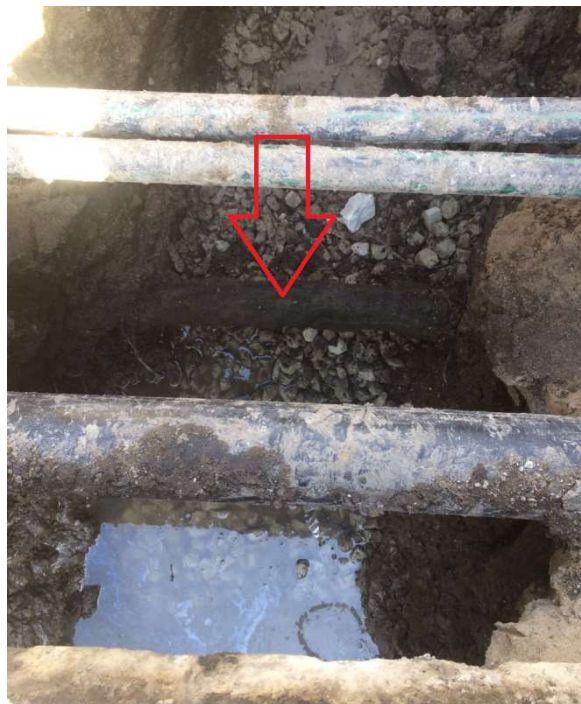
Joonis 1.17 Tundmatu kaabel (väljavõtte täitedokumentatsioonist)
