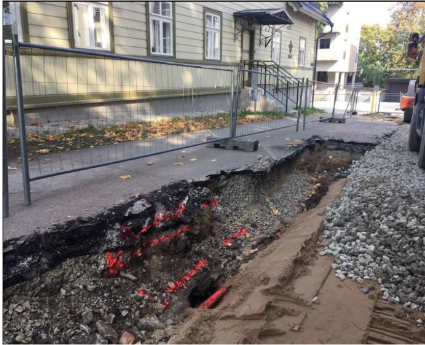
Joonis 1.5 Türi tn 2 maja ees olemasolev 35kV (kilovolt) kaabel kõrgel (väljavõtted projekti täitedokumentatsioonist, tähega L on märgitud liiva kõrgus. Ülemine joon on sõidutee asfalt)
