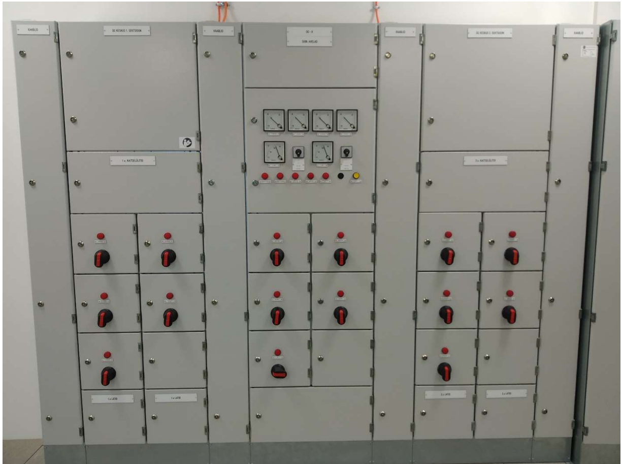
Joonis 1.9 110V DC keskus 110 kV alajaamas
