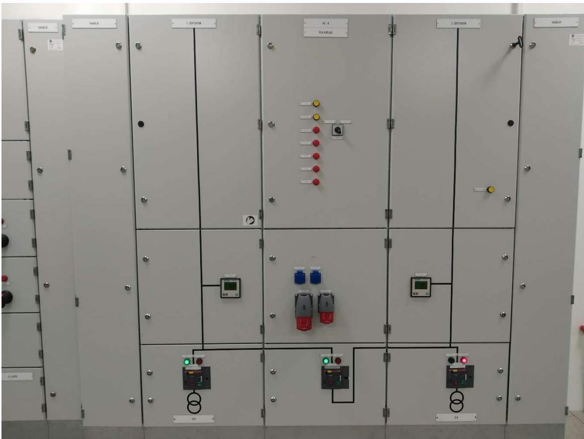
Joonis 1.4 0,4 kV AC keskus 110 kV alajaamas
