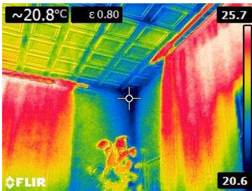
Termofoto 2. Hoone lõunanurga seestvaade I korrusel.
