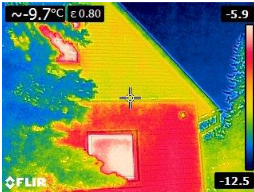
Termofoto 1. Hoone kagukülg.
