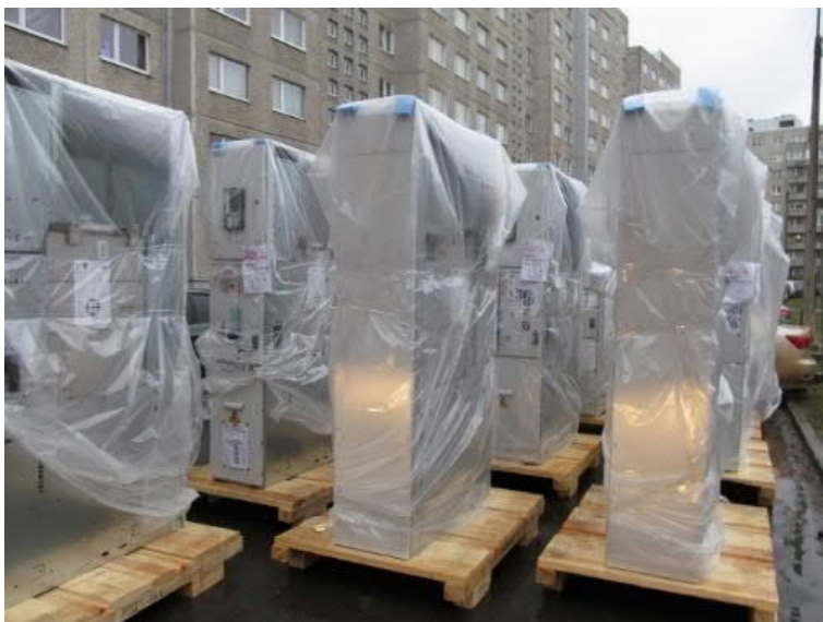
Foto 1.1 Jaotusseadme NXPlusC paneelid puitalustel
