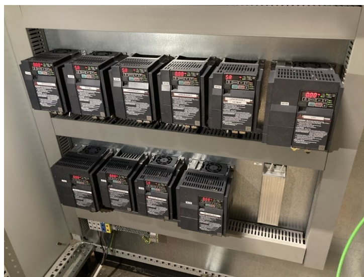
Joonis 4.1 Elektrikilp EK10: lipiliini sagedusmuundurid
