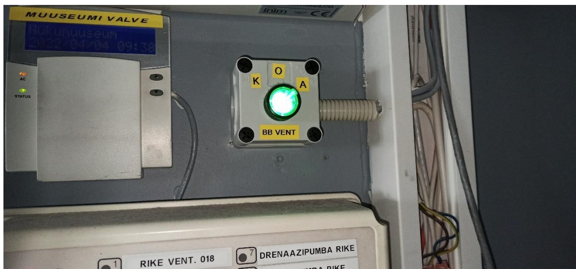
Joonis 4.8 Noorsooteatri väikse saalis asuv ventilatsiooni juhtimise lüliti
