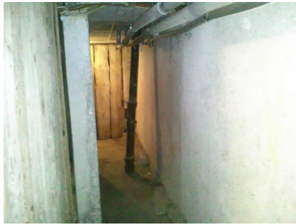
Pilt 11. Kanalisatsiooni püstik keldris
