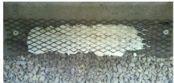
Pilt 14. Katuse tuulutused fassaadis
