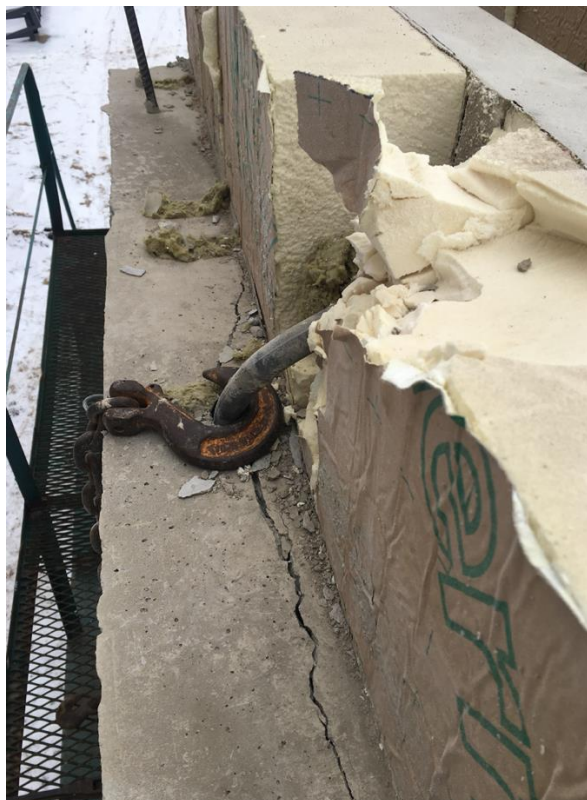
Joonis 5.28 Raudbetoonist seinaelementi läbiv pragu (Foto autor: objektiinsener T. Stern)
