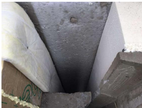
Joonis 5.20 Tühimik soojustusplaatide vahel (Foto autor: objektiinsener T. Stern)
