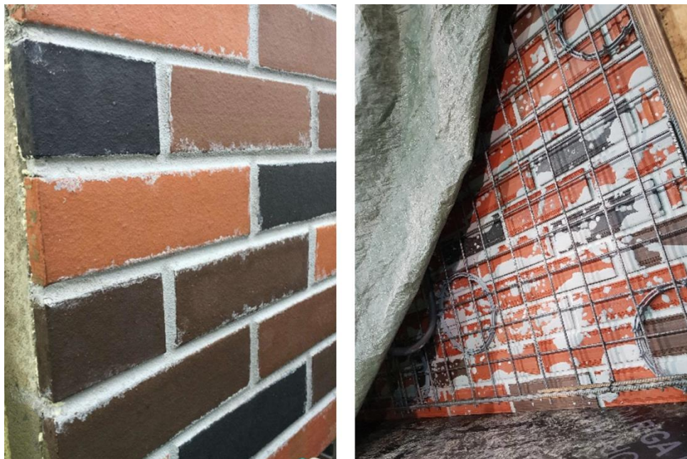
Joonis 5.17 Tellisplaatide määrdumine (Parempoolsel fotol on näidatud tehases vuugitud tellisplaadid, vasakpoolsel fotol lõpptulemus) (vasakpoolse foto autor: objektiinsener T. Stern, parempoolse foto autor: kvaliteedijuht A. Gildi)
