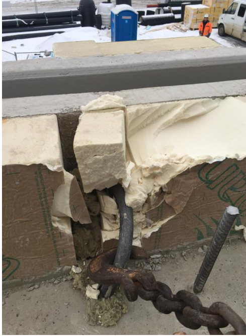
Joonis 5.22 Defektne soojustus raudbetoonist seinaelemendis (Foto autor: objektiinsener T. Stern)
