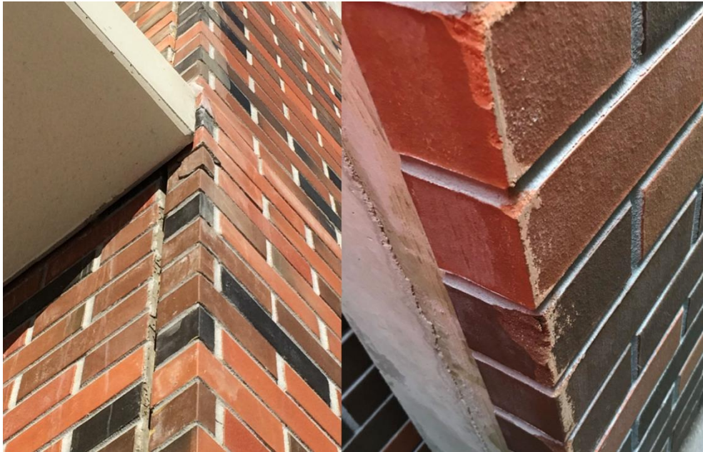
Joonis 5.15 Defektsed tellisplaadid (Fotode autor: objektiinsener T. Stern)
