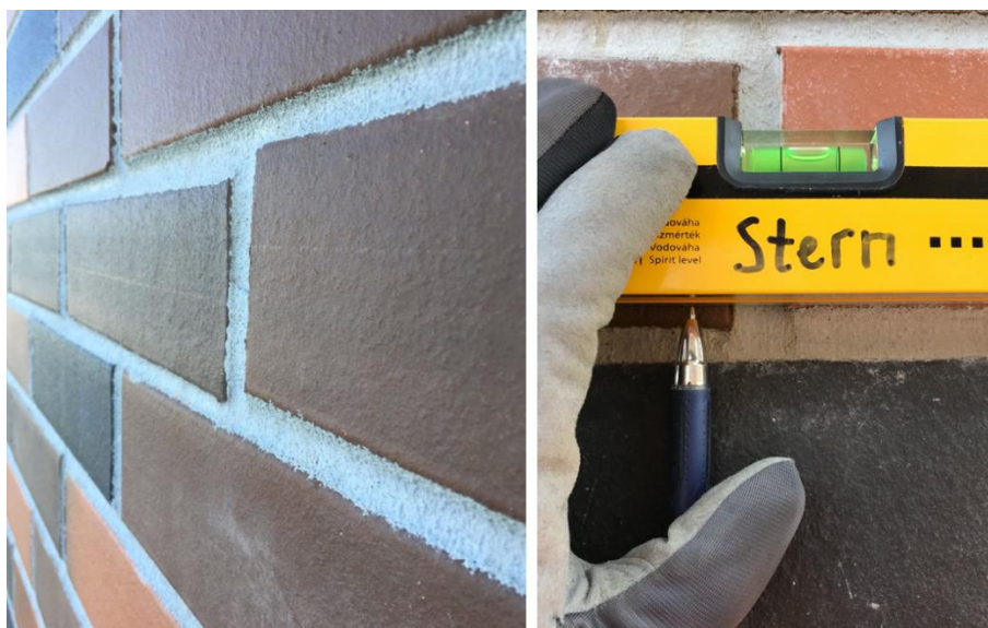
Joonis 5.12 Telliste kõverdumine (Fotode autor: objektiinsener T. Stern)
