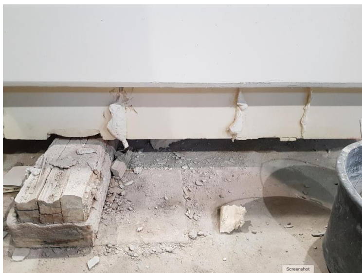
Joonis 5.23 Raudbetoonist seinapaneeli defektne soojustus (Foto autor: kvaliteedijuht A. Gildi)
