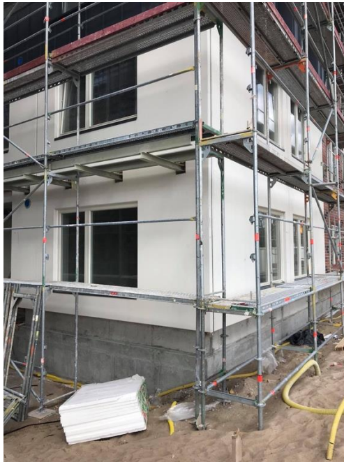
Joonis 2.4 Veerenni Kvartali värvitud pinnakattega seinaelemendid (Foto autor: objektiinsener T. Stern)
