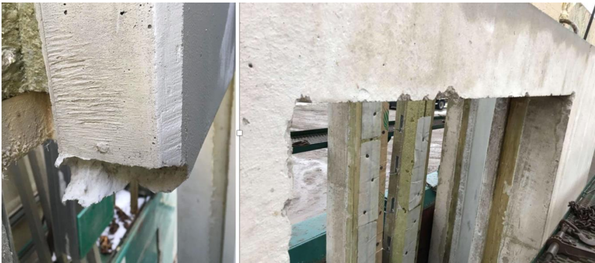
Joonis 5.27 Defektne betoonserv (Fotode autor: objektiinsener T. Stern)
