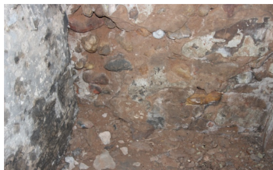
Joonis 3.4 Põhjapoolse keldrissepeäsu seinast kukkunud kivid (autori foto)
