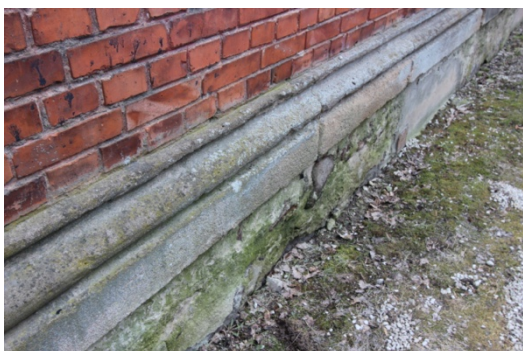
Joonis 3.2 Põhjakülje kahjustused (autori foto)
