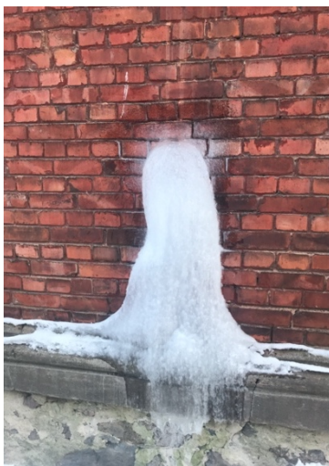
Joonis 3.61 Põhjakülje tilkuv gaasikatla korsten (autori foto)
