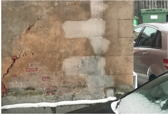
Joonis 3.53 Läbikülmunud sein, valged laigud seinal on soolkahjustused (autori foto)
