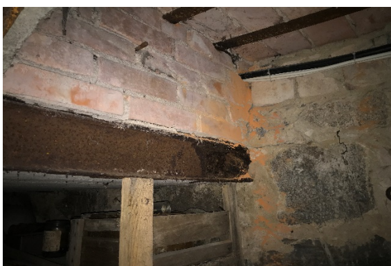
Joonis 3.8 Korrodeerunud I-tala keldris (autori foto)
