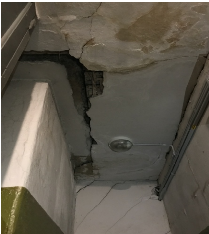
Joonis 3.49 Lae- ja seinakahjustused (autori foto)
