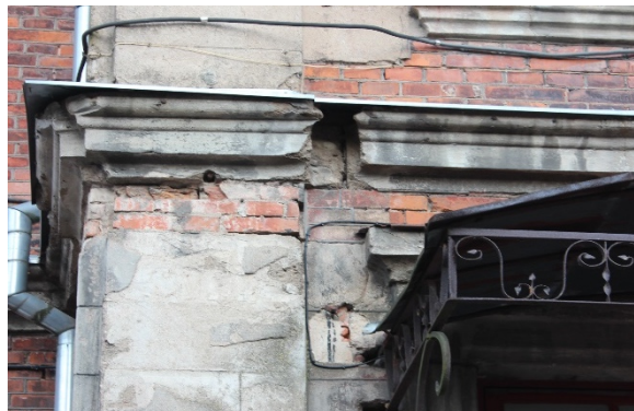
Joonis 3.16 Krohvikahjustused fassaadil (autori foto)
