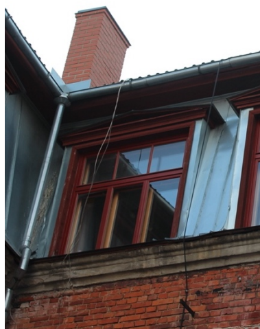
Joonis 3.60 Fassaadil rippuvad juhtmed (autori foto)
