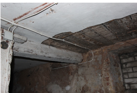
Joonis 3.7 Puittalale toetuv krohvikahjustustega keldrilagi (autori foto)
