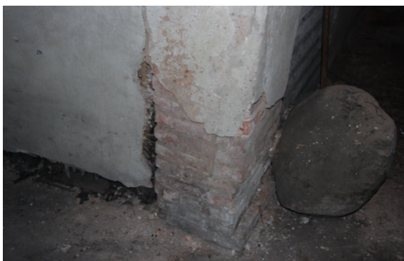
Joonis 3.5 Kahjustunud seinakonstruktsioon (autori foto)
