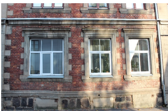
Joonis 3.15 Esifassaadi pragudega ja vajunud põhjapoolne serv (autori foto)
