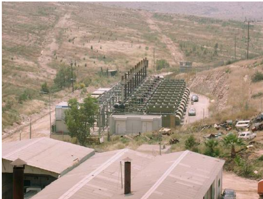
Joonis 1.11 Prügilagaasi töötlev tehas [12]
